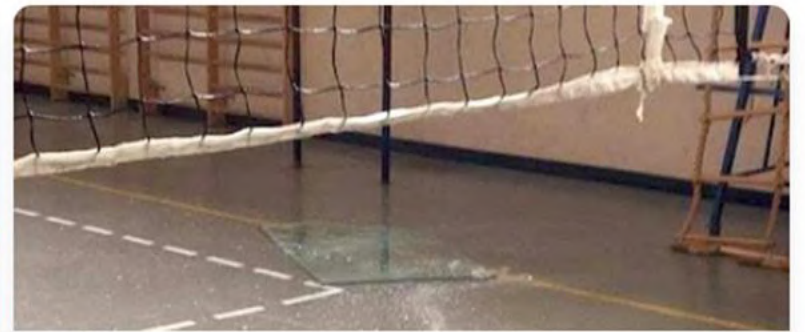
A Genzano è caduta una finestra nella palestra della scuola, sfiorati i ragazzi.
